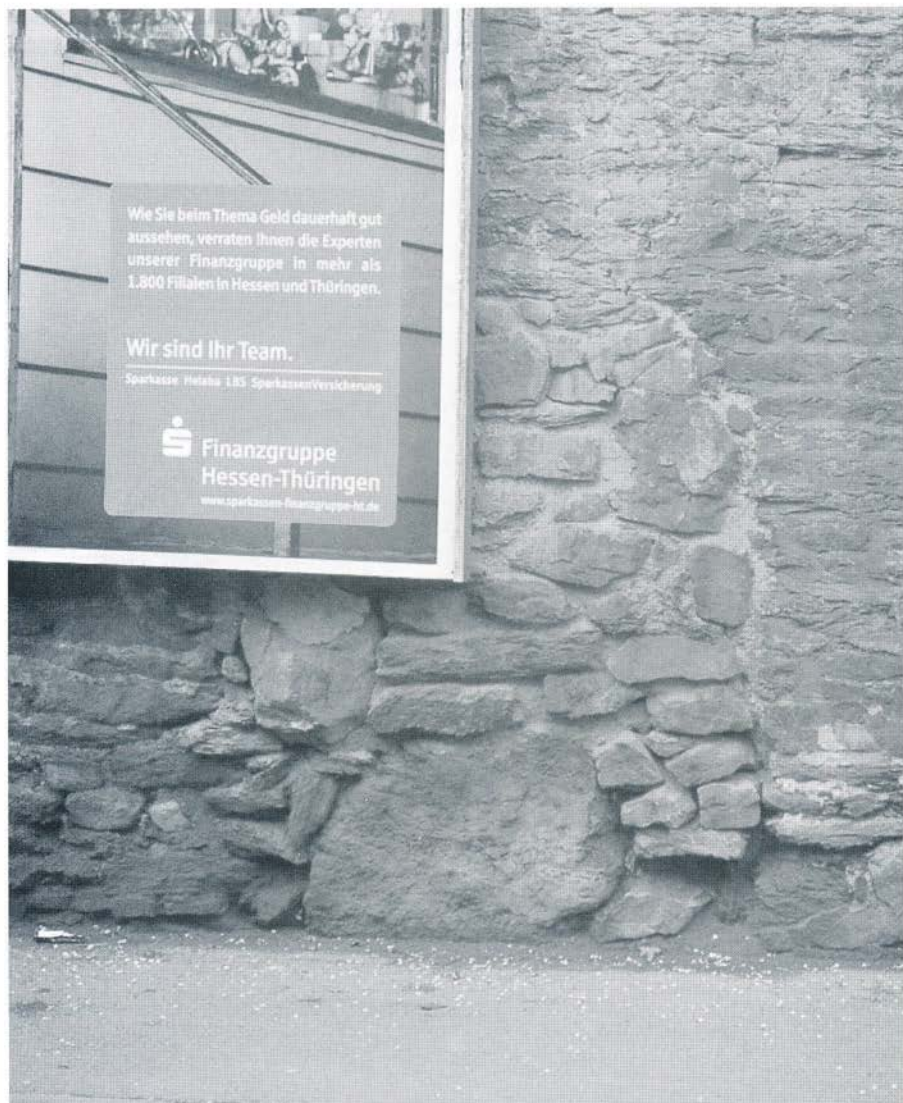
Zugemauerter Eingang zum geplanten Bunker in der Frankfurter Straße. (Foto: M. Traut)
