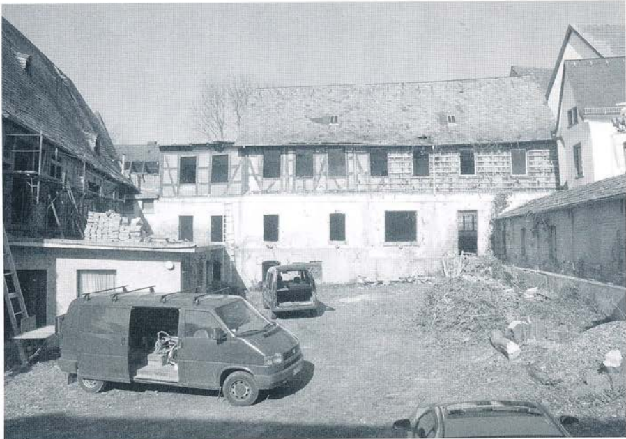
Hofansicht mit beidseitig flankierender Bebauung des späten Mittelalters. Links grenzt das parallel zur Stadtmauer verlaufende Hauptgebäude und rechts der im Kern spätmittelalterliche, verputzte Fachwerkgiebel des Anbaus eines lang gestreckten, noch nicht erforschten Gebäuderiegels an.
